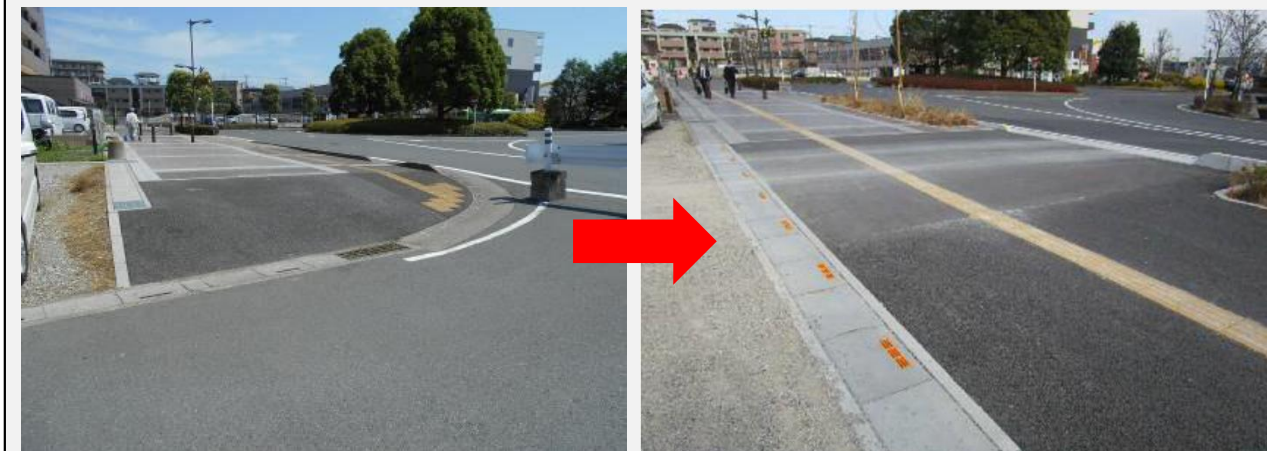
視覚障害者誘導用ブロックの改修、グレーチングを目の細かいものに改修
